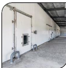
Puerta del Frigorífico
