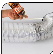
Conducto de aire acondicionado
