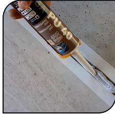
Junta de Dilatación
