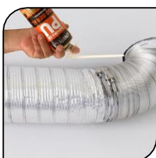
Duto de Ar Condicionado
